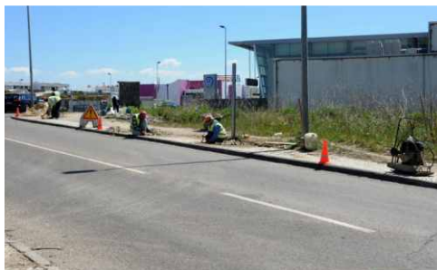
Requalificação da via pública com uma intervenção do passeio da Estrada de Vale Mourelos com a Rua Joaquim Pires Jorge, no Feijó.
